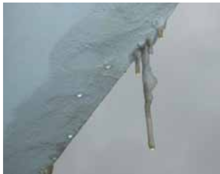
> Figura 2: Falta de revestimento da cuba e as consequentes patologias (estalactites)
