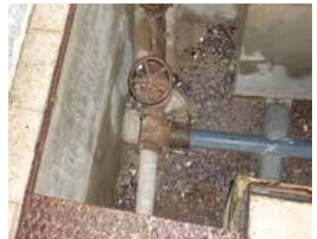
> Figura 3: Estado de envelhecimento das tubagens e dos órgãos complementares
