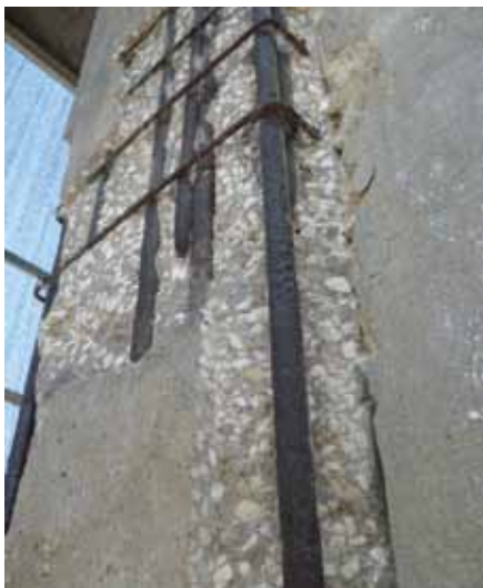
> Figura 1: Degradação superficial do betão armado da estrutura do reservatório.
